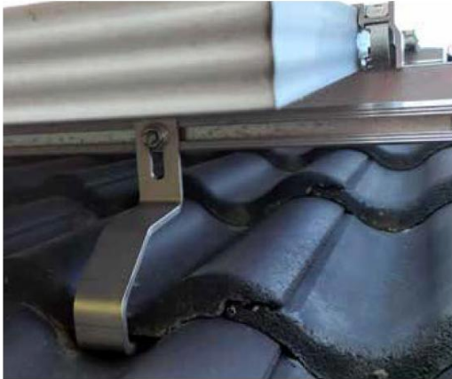
Kuva 24. Tiilikatekiinnitys S-mallisella kattokiinnikkeellä. Kiinnikkeen paikka säädetään ja ylemmää tiiltä hiotaan niin, ettei se lepää alemman kattotiilen päällä edes kuormituksen alaisena.
