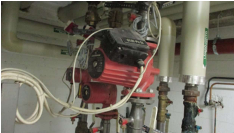
Lämmitysverkoston pumput 2, joita on kolme kappaletta.
