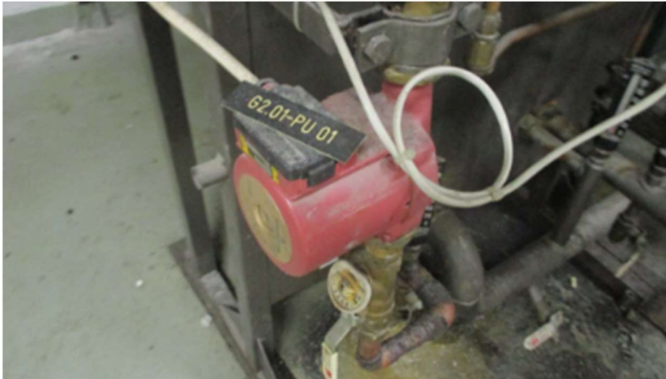
Lämpimän käyttöveden kiertopumppu.
