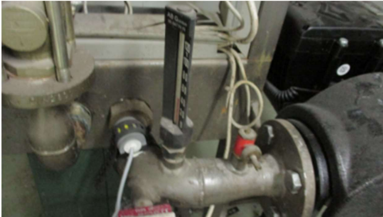
Lämpötilan mittausanturi ja nestepatsaslämpötilamittari.
