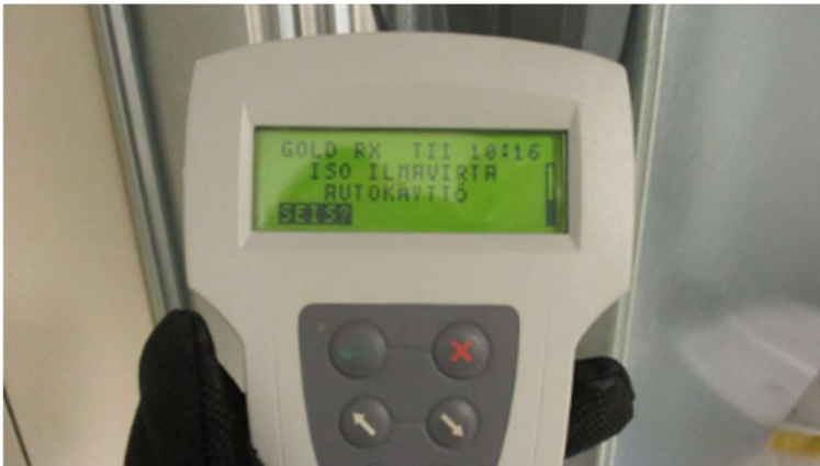
Swegon tuloilmakoneen säädin tiloissa.
