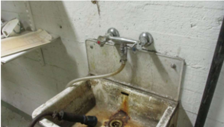
Lämmönjakuhuoneen hana ja putket seinässä vuodelta 1964.
