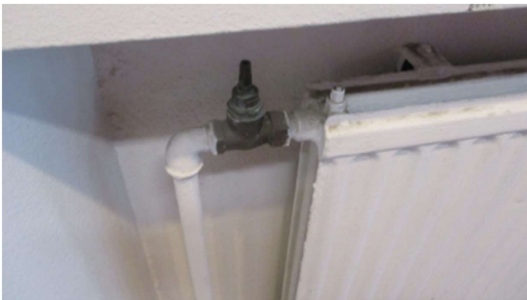
Alkuperäinen vm. 1964 ei-esisäädettävä patteriventtiili ja alkuperäinen ilmausruuvi.
