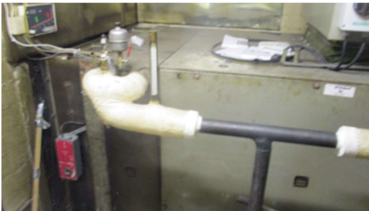
Alkuperäinen vuoden 1964 toimistokerrosten tuloilmakone asbestieristeineen.
