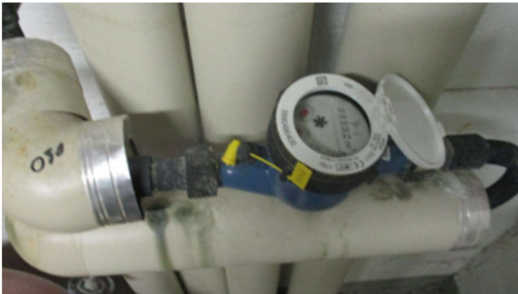
Erillisiä vesimittareita on kiinteistössä.
