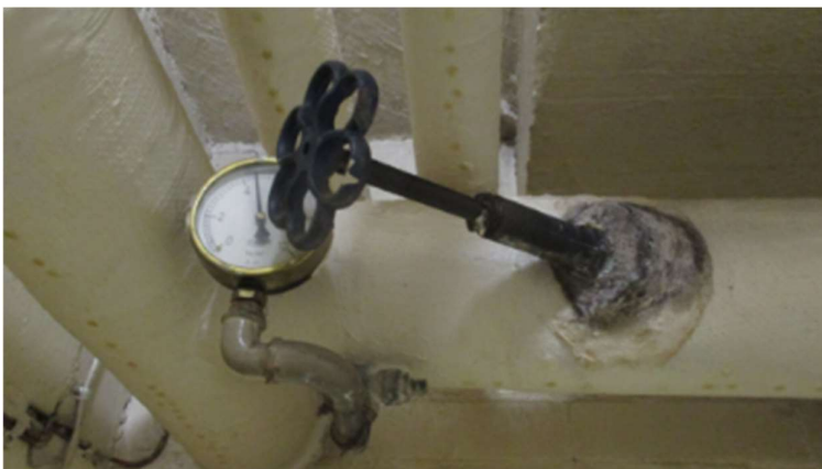
Asbestieristeen sisällä oleva alkuperäinen karaventtiili.
