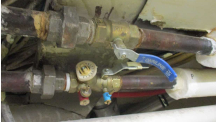
Lämmitysputkia ja linjaventtiilejä.
