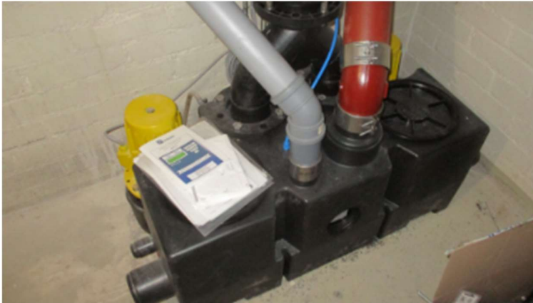
Pieni jäteveden säiliöpumppaamo vuodelta 2019.
