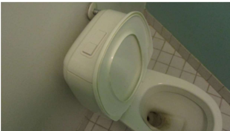
Ilmeisesti alkuperäinen WC-laite, joka on jo elinkaarensa päässä. Uusitaan putkisaneerauksessa.
