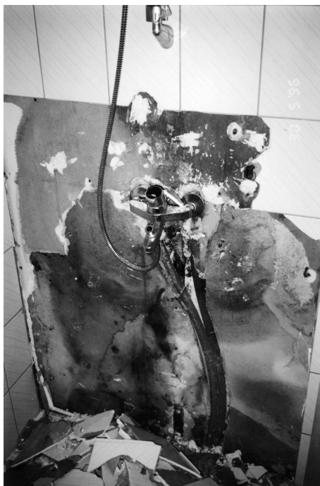
Kuva 2. Kolme vuotta vanha märkätilan seinärakenne on pahoin kastunut ja lahovaurioitunut. Hanakulmat ovat jääneet tiivistämättä ja kipsilevyseinässä on käytetty kosteussulkuemulsiota vedeneristykseen sijasta.
