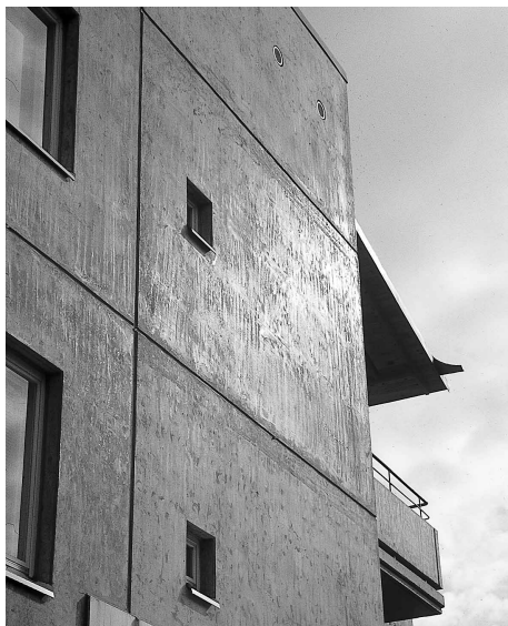
Kuva 4. Liian sileään uuteen betonipintaan maalit eivät tartu.
