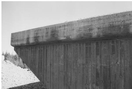
Kuva 19. Härme-esiintymää laudalla muotitussa sillan reunapalkissa. Ulkovalut ovat herkkiä härmeen muodostumiselle. Sillan maatuessa näkyy hyvin sahatavaran erilaisesta kosteuspi-toisuudesta ja vedenimukyvyistä aiheutunutta värieroa.
