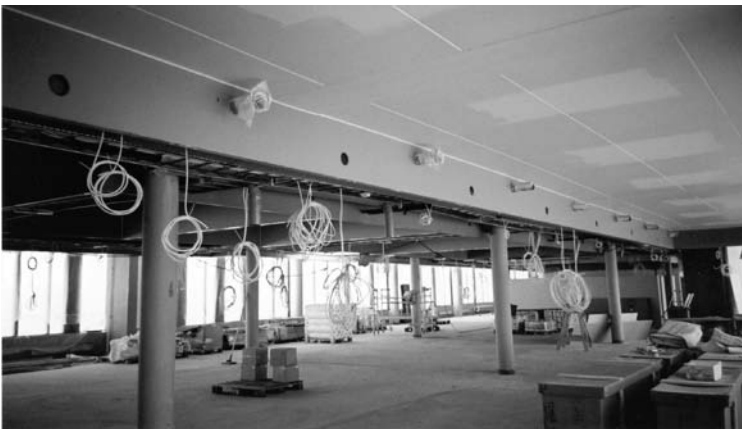
Kuva 1. Työmaan siisteydestä ja puhtaudesta tulee huolehtia jo koko rakennushankkeen ajan. Tämä helpottaa työn tekemistä ja edistää myös työturvallisuutta. Tässä esimerkki siististä työmaasta.
