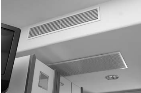
Kuva 8. Esimerkki induktiolaitteesta hotellihuoneessa. Sama asennustapa soveltuu myös asuntoihin. Kuva: Halton Oy.
