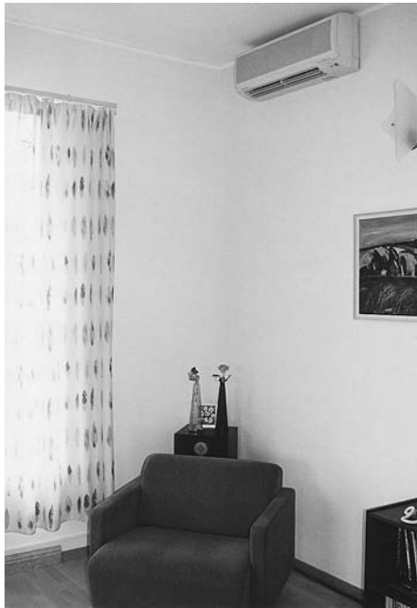
Kuva 9. Esimerkki olohuoneeseen, suuren lasipinnan viereen asennetusta Split-tyyppisen ilmalämpöpumpun sisäyksiköstä. Kuva: TTK LVI-laboratorio.
