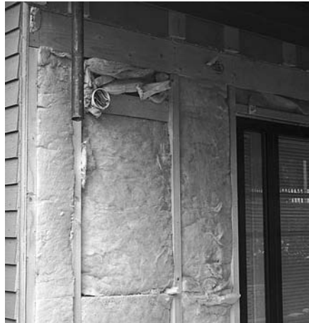
Kuva 1. Vajaaksi jäänyt eristys aiheutti vilun tunnetta ja sai aikaan lämpövuotoa. Korjaustoi- miin ryhdyttiin lämpökamerakuvaustulosten selvityttyä.
