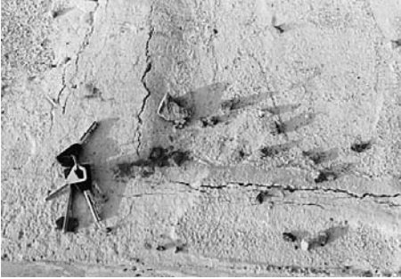
Kuva 3. Betonipintaan raudoituksen yläpuolelle avautuneita plastisen painuman halkeamia. Tässä halkeamien kohdalla on yläpinnan terästanko. Betonin jälkikäytyks oli tiivistänyt rakenteen ja estänyt halkeamien muodostumisen.
