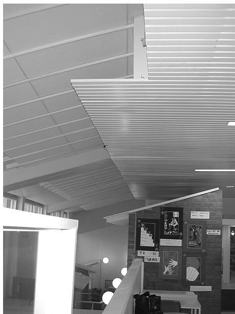
Kuva 5. Koulujen suunnitteluratkaisuissa tulisi kiinnittää enemmän tilojen siivottavuuteen. Oheisessa koulun aulatilassa on erittäin paljon pölyä kerääviä yläpintoja, joiden siivoaminen on erittäin vaikeaa. Korjausten yhteydessä hyvin toteutetulla suojauksella vähennetään pölyn leviämistä ympäröiviin tiloihin.
