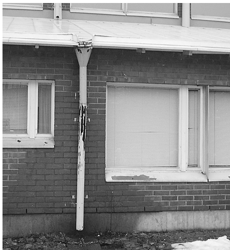
Kuva 4. Mikäli kuntotutkimuksen esiselitysvaiheessa havaitaan selviä vaurioiden syitä, tulee korjaustoimet käynnistää välittömästi.
