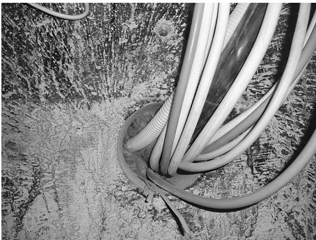
Kuva 3. Tyypillinen epätiivis läpivienti kerrosten välillä tai ryömintätilasta käyttötiloihin mahdollistaa epäpuhtauksien kulkeutumisen.
