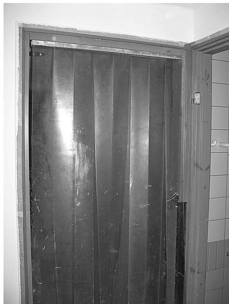
Kuva 2. Muovilamellioivella IV-asennusalueen osastointi onnistuu hyvin.
