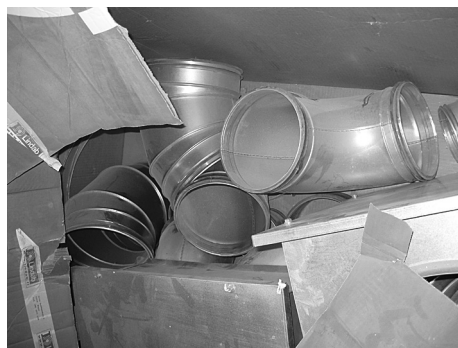
Kuva 3. Ilmanvaihtojärjestelmän osien suojaamisen laiminlyönti on yleinen ongelma. Kuvan osat eivät ole enää puhtausluokan mukaisessa kunnossa.
