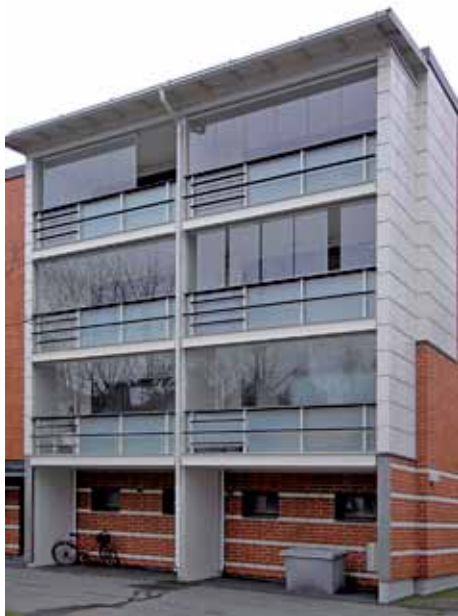
Kuva 6. Remontin yhteydessä kannattaa ehkäistä uusia vaurioita suojaamalla säälle alttiit päädyt ja pielet sekä kattorakenteet vaurioitumiselta. Jokaisen parvekkeen oma vedenpoisto on syytä varmistaa kunolla ja myös huolehtia, että katon vedenpoisto hoidetaan erillisenä muun veden poiston kanssa. Tällä ehkäistään katon sulamisvesien jäätyminen varjossa olevan parvekkeiden läpi kulkevan syöksytorven matkalla keväällä. (Kuva: Lumon Oy).
