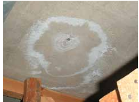
Kuva 6. Katon läpiviennin kohdalla esiintyvä kosteusrasituksen merkki.
