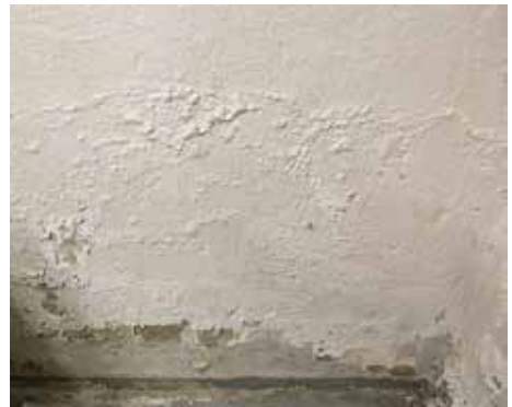
Kuva 3. Maalipinnan voimakasta hilseilyä maanvastaisen seinän alaosassa.
