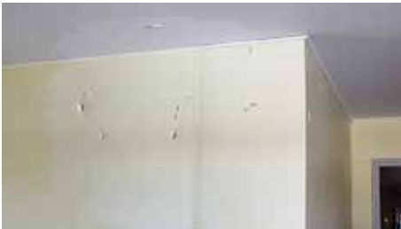
Kuva 9. Väliseinässä esiintynyttä maalipinnan hilseilyä, jota on yritetty korjata uudelleen maalaamalla.
