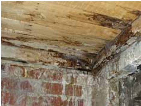
Kuva 5. Paikallinen kosteusvaurion aiheuttama puurakenteiden tummuminen ryömintätalilassa.
