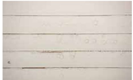
Kuva 7. Tiivistyneen kosteuden katon paneelipintaan aiheuttamia kosteusjälkiä.
