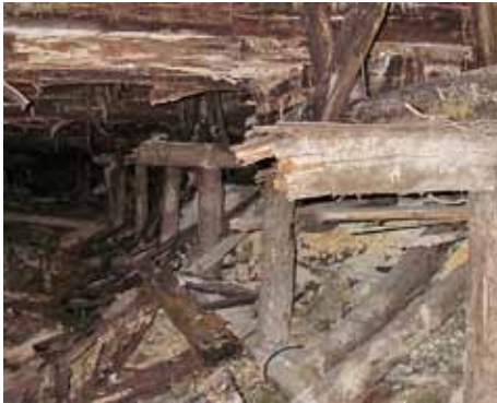
Kuva 4. Muottilaudoitusten pitkälle edenneitä mikrobi- ja lahovaurioita ryömintätalilassa.
