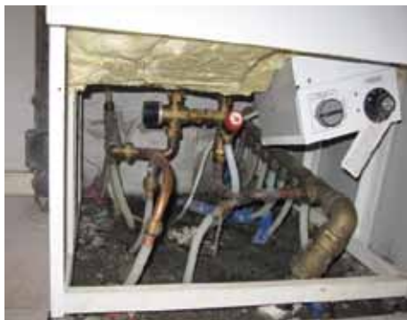
Kuva 2. Varaajan alla eristämätön lattiapinta.
