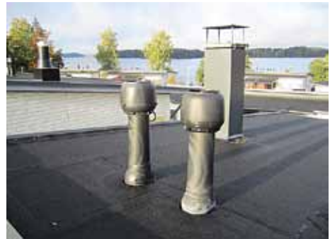
Kuvat 13 ja 14. Esimerkit vesikattotason yläpuolelle asennetuista alipaineistuksen huippumureista.
