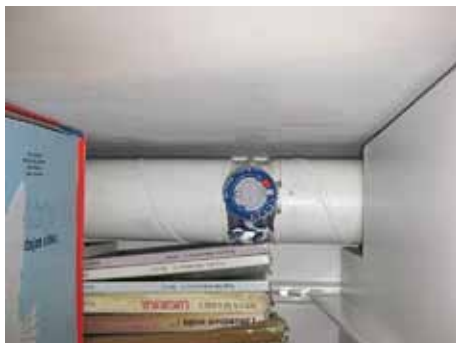
Kuvat 11 ja 12. Esimerkit alipaineistusjärjestelmiin asennetuista mittaus- ja säätörenkaista.
