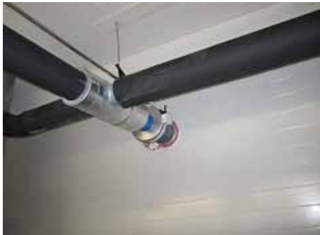
Kuva 15. Esimerkki alipaineistusjärjestelmään kuuluvasta rakennuksen sisäpuolisesta poistopuhaltimesta.
